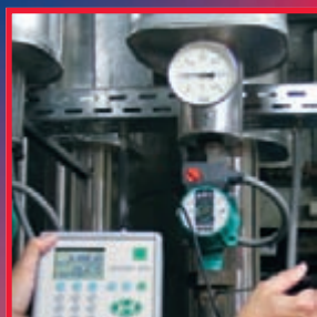
Comprobación de una instalación de calentamiento
